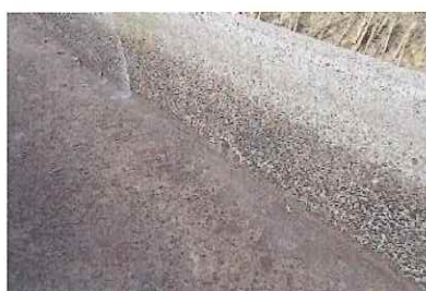
水路表面の磨耗
