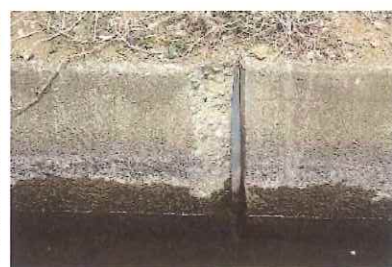
水路目地の欠損
